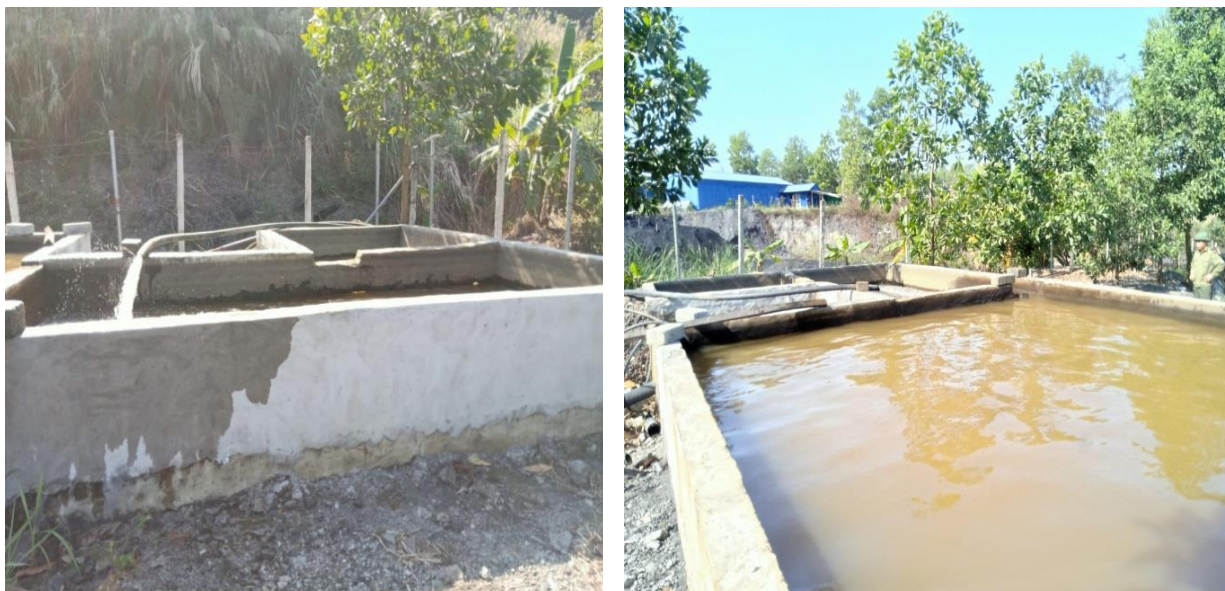
Hình 3.9. Bể lọc 30m 3
