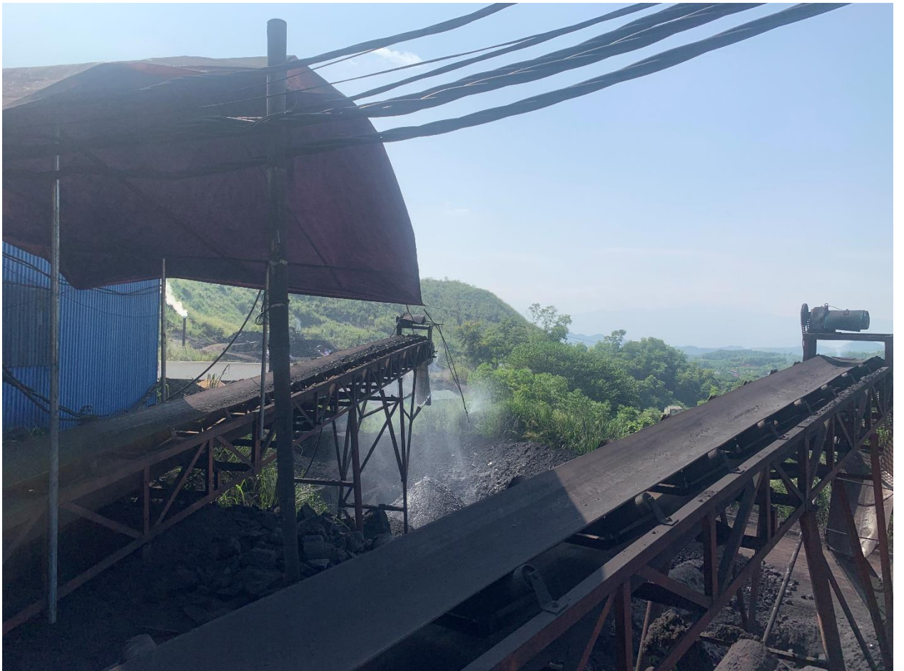
Hình 3.10. Hệ thống phun sương tại các điểm rớt than.
