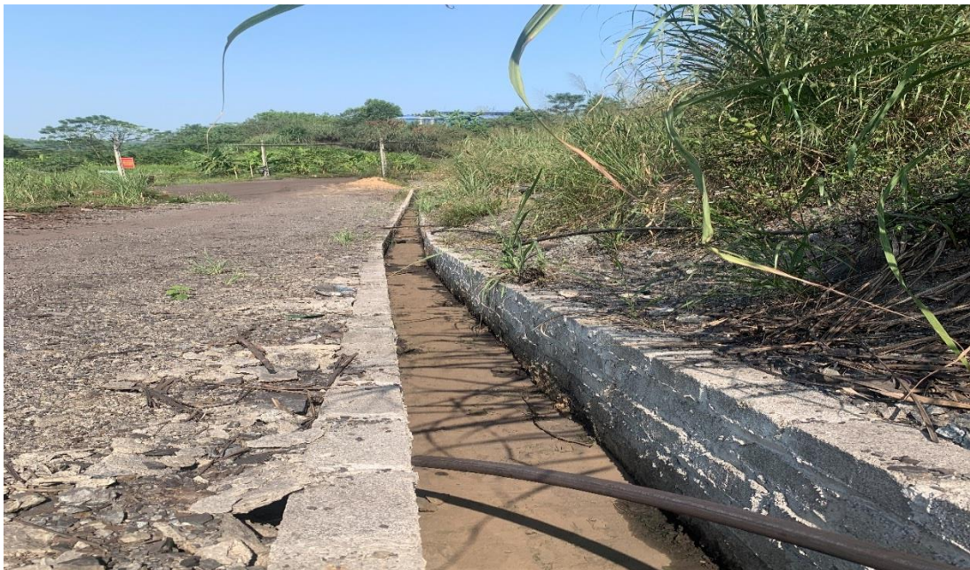
Hình 3.1. Hệ thống mương thoát nước (dài 650m).
